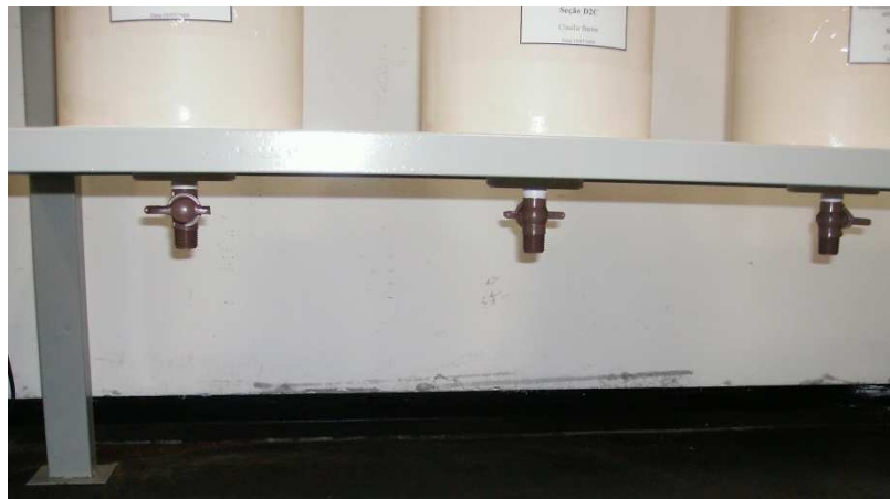
Figura 4.7. Detalhe da base dos reatores mostrando as válvulas para escoamento do percolado.
